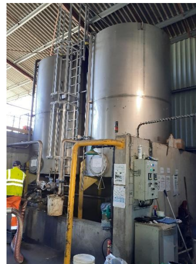
Photo 8 : Zone Z1 – Dépotage et stockage des eaux souillées
