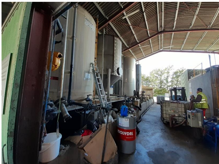
Photo 7 : Zone Z1 – Dépotage et stockage des eaux souillées
