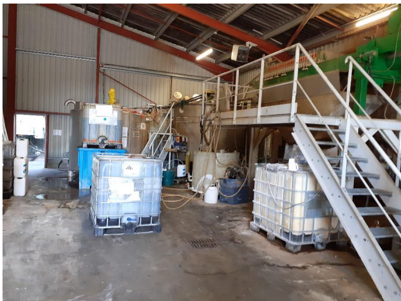
Photo 5 : Bâtiment D1 – Traitement des eaux souillées
